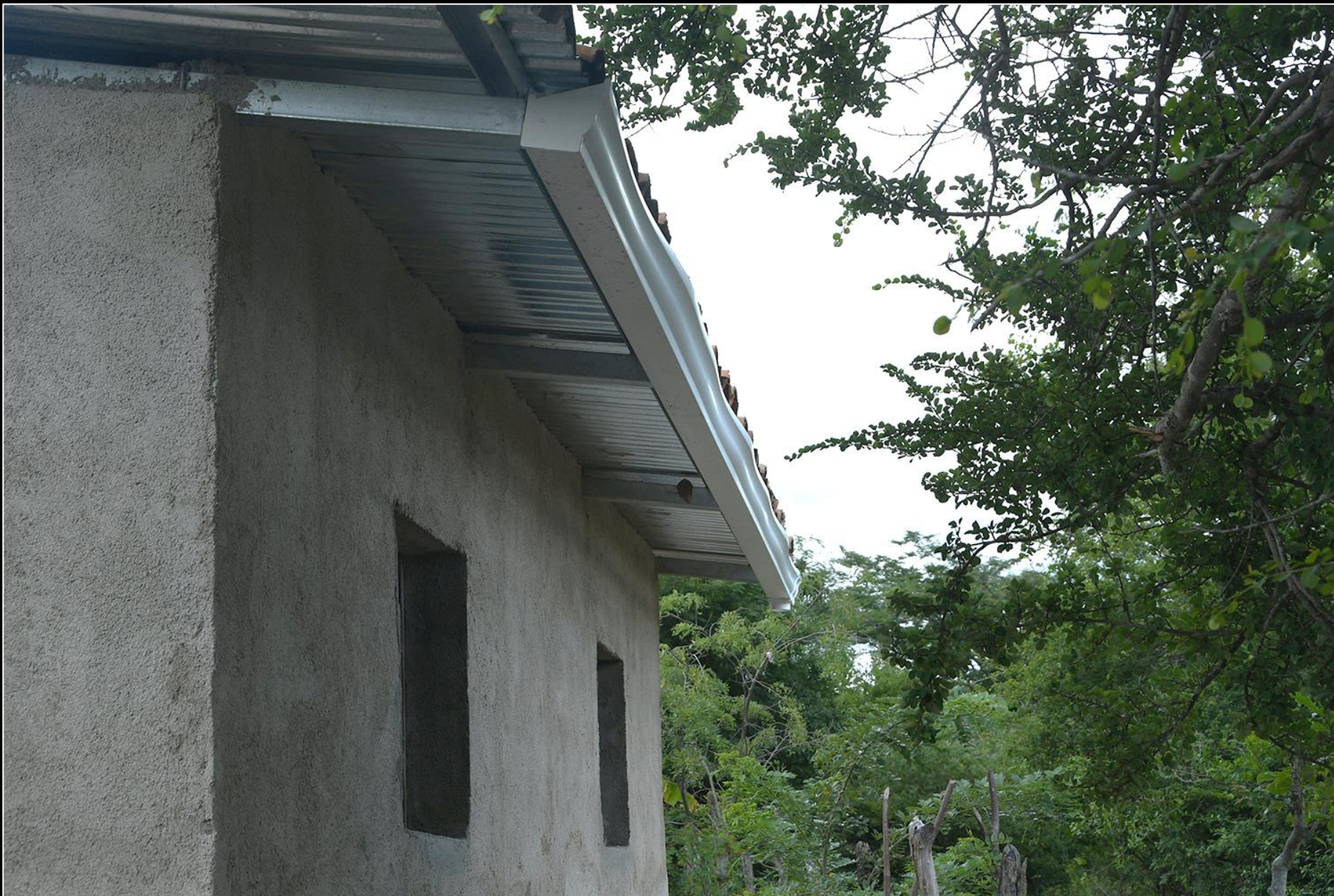
Recogida de aguas pluviales
